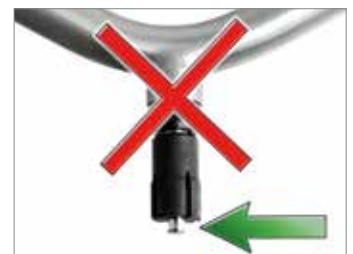
Spreizdübel zu weit eingedreht
